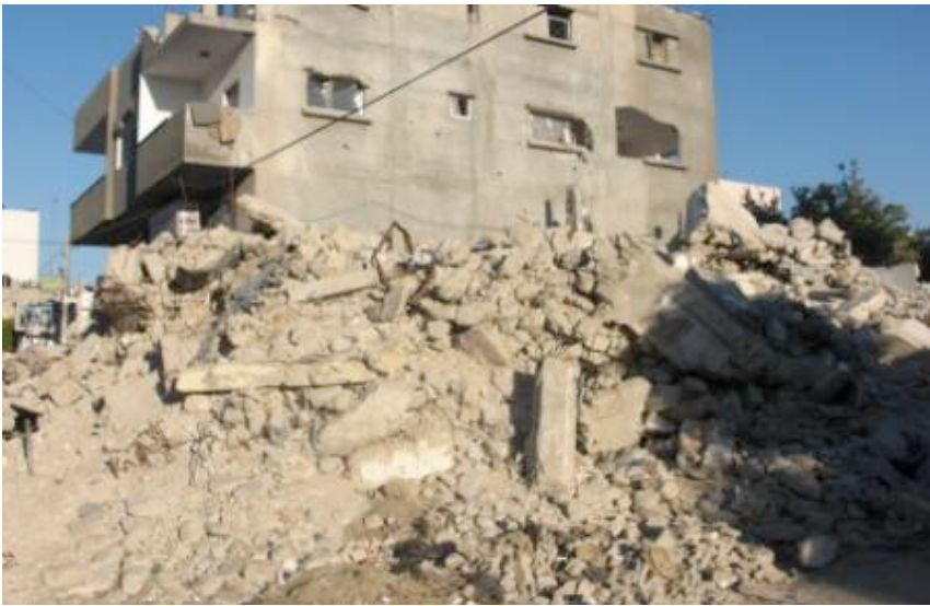
Shattered homes in Deil El Balah
